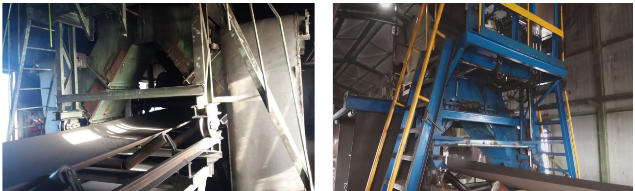
图4 改造前、后的皮带布料小车现场对比图
