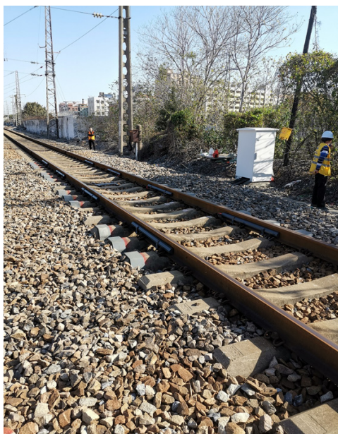
图5 系统现场实物照片
